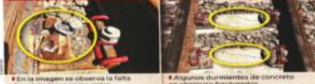
En la imagen se observa la falta de sujetadores en los rieles. Algunos durmientes de concreto se observan fracturados.
