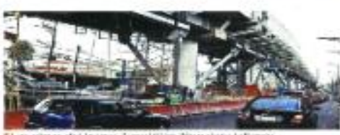
Las obras del tramo Zapotitlán-Nopalera fallaron.
