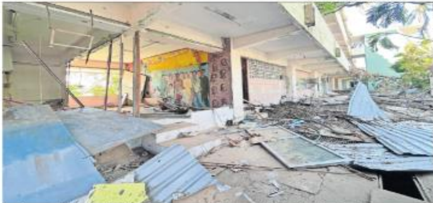
Escuelas como la Federal 1 en Acapulco, resultaron severamente dañadas por el huracán del 25 de octubre. Aún permanecen los escombros en las aulas y no hay todavía plan de restauración ni fecha de regreso a clases.
