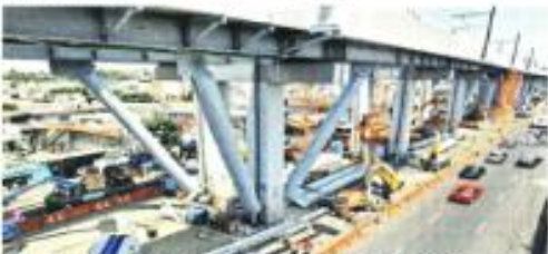
Una trabe del tramo elevado de la Línea 12 del Metro se desplomó el 3 de mayo de 2021.
