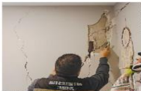
Personal de Protección Civil revisa los daños por los microterremotos en el edificio habitacional Los Palcos, en México.
