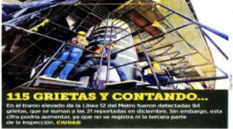
115 GRIETAS Y CONTANDO... En el tramo elevado de la Línea 12 del Metro fueron detectadas 94 grietas, que se suman a las 21 reportadas en diciembre. Sin embargo, esta cifra podría aumentar, ya que no se registra ni la tercera parte de la inspección. CIUDAD
