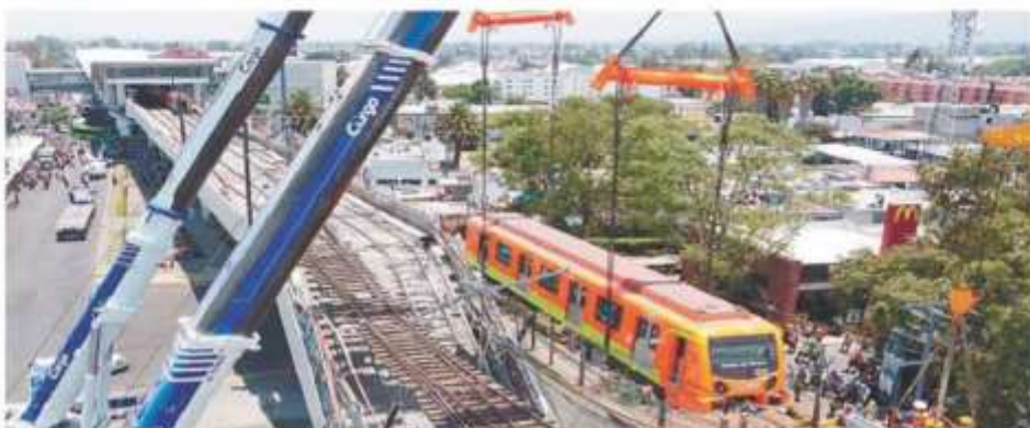
Uno de los vagones que cayó del tramo elevado de la llamada Línea Dorada fue removido con dos enormes grúas para trasladarlo a los talleres del Metro. Autoridades cercaron el perímetro para evitar más accidentes.
