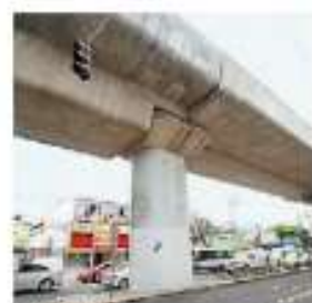
Obra defectuosa. ESPECIAL
