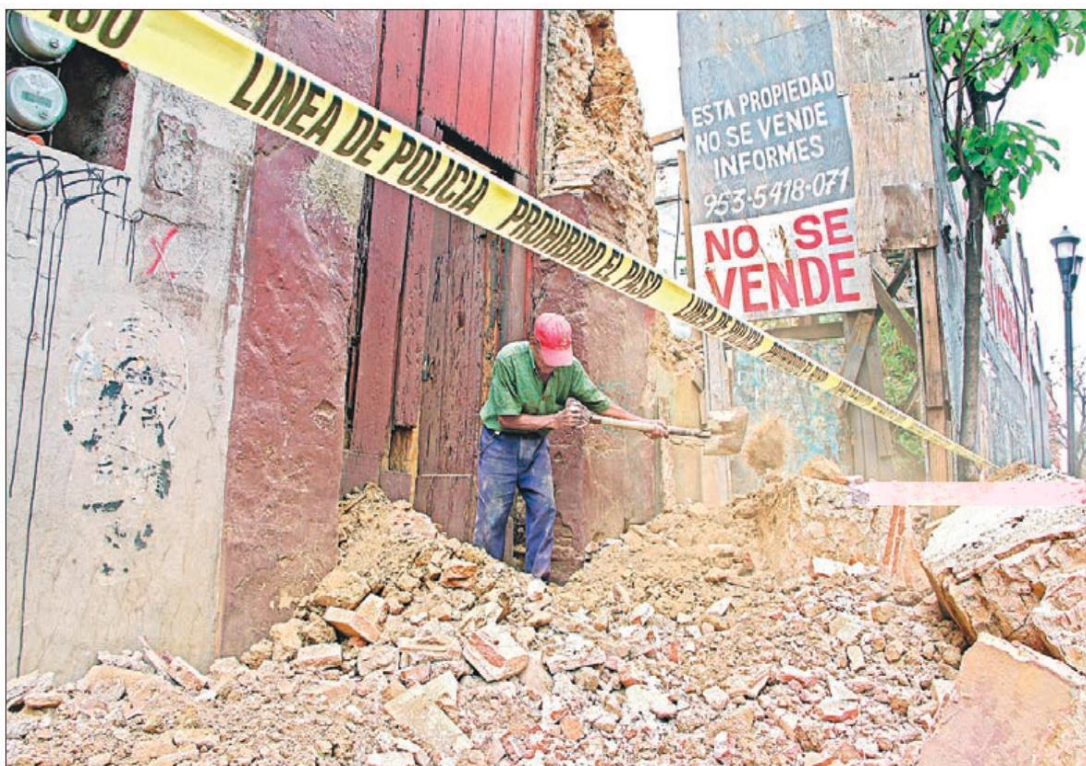
▲ Viviendas del Centro Histórico de Oaxaca capital (imagen) resultaron dañadas por el sismo de magnitud 7.5. Las mayores afectaciones ocurrieron en localidades de la Sierra Sur de la entidad.
