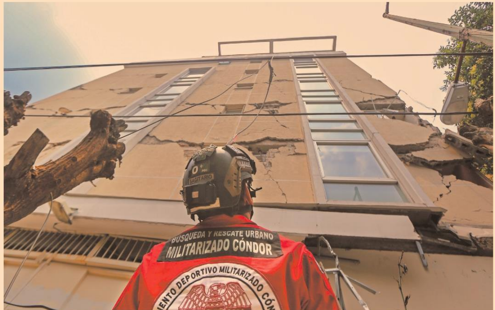
Estructuras. Edificios, sobre todo en Oaxaca y la capital del país, se dañaron y algunos fueron desalojados. FOTO EE: ERIC LUJO
